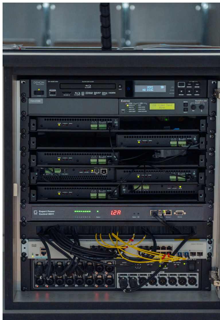
Expert Power Control 8031-1 steuert und überwacht die Stromversorgung im 19-Zoll-Rack im Pult des Hörsaals Foto: © Universität Siegen
